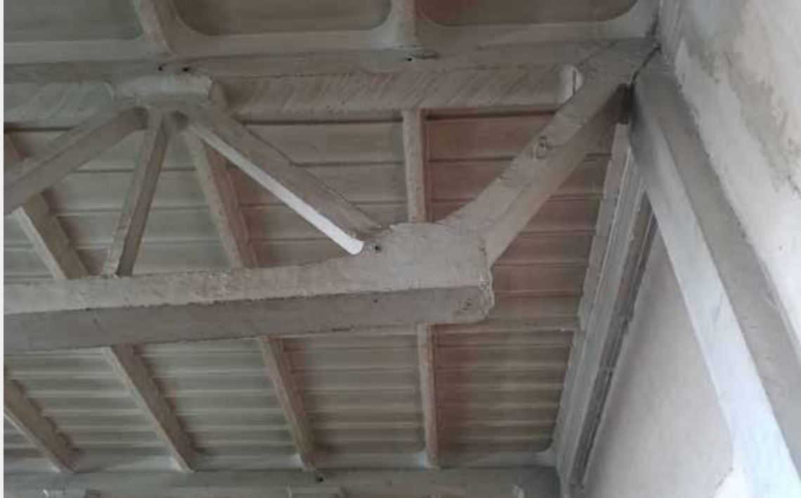
▲ Obr. 12 Zcela zásadní pro celý vazník je zasažení předpjaté výztuže korozí v krajních diagonálách
